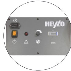
Bedienfeld mit Betriebsstundenzähler und Lüfterdrehzahlregelung
